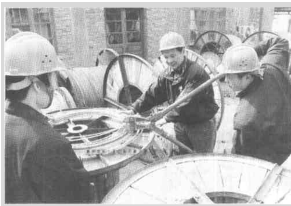
广饶县电力安装公司在电力安装工程中，积极开展节约挖潜活动，大大地降低了成本，杜绝了浪费现象，使该公司保持良好的发展势头，获得了较好的效益。(高梓 李俊生 摄)
