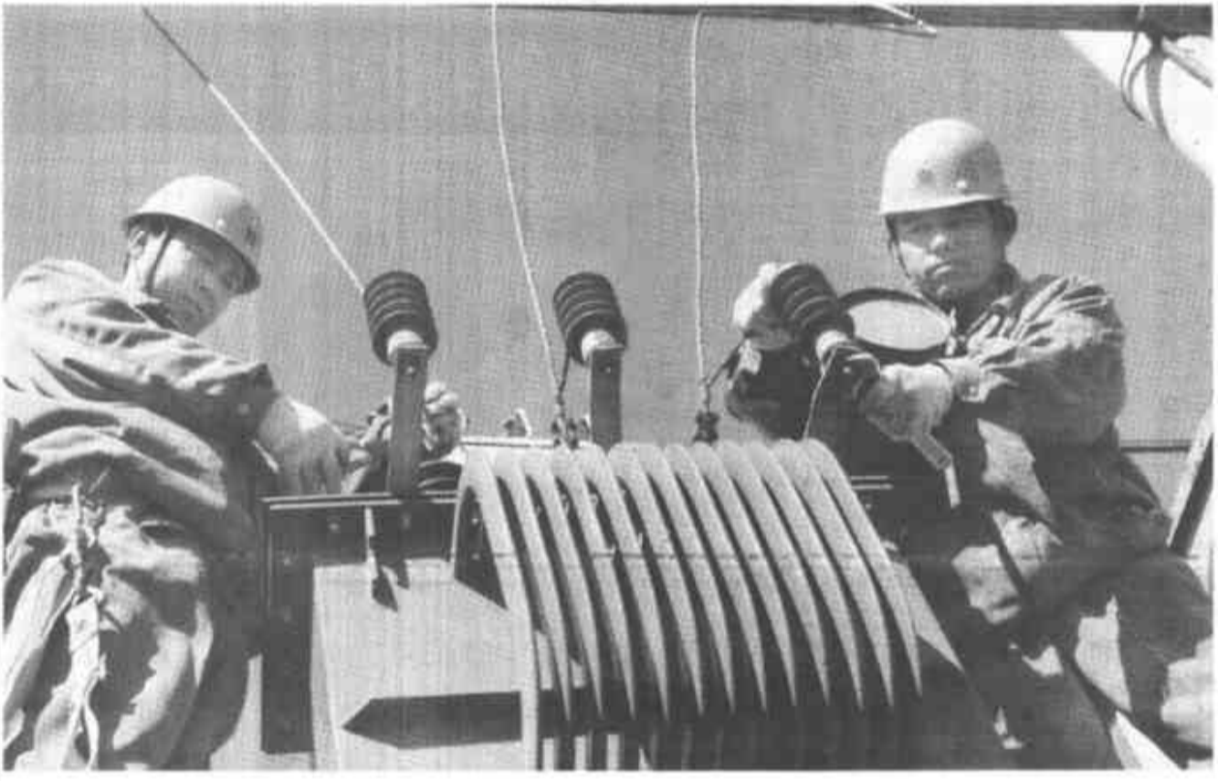
连日来，利津县汀河供电所组织专门力量对辖区314.79千米供电线路及196台变压器全部进行检查检修，以确保十六大期间供电安全畅通，让广大群众随时可以收看报道十六大的电视节目。 (徐兆鹏 田祝和 摄)
